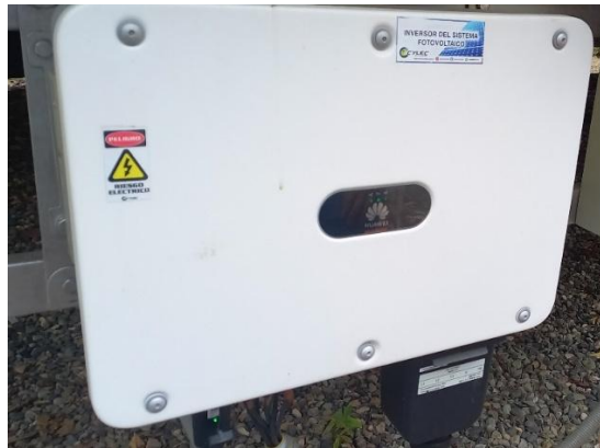
Figura 3: Inversor utilizado, inversor trifásico Huawei SUN2000-20KTL-M3. Fuente: Elaboración propia.
