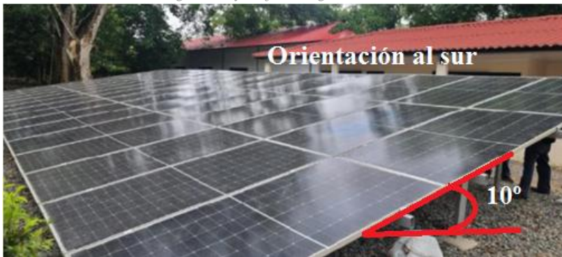
Figura 2: Módulos fotovoltaicos instalados en el sitio de medición. Fuente: Elaboración propia.
